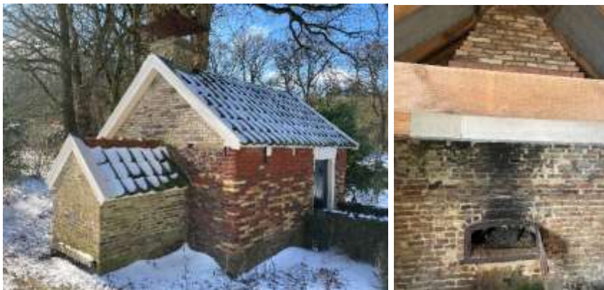
Afb. 84 Het bakhuisje van Groot Boeschoten met oven en aan de binnenzijde de ovendeur (P. Schut).
